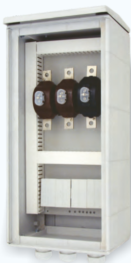
Orman sa strujnim transformatorima
