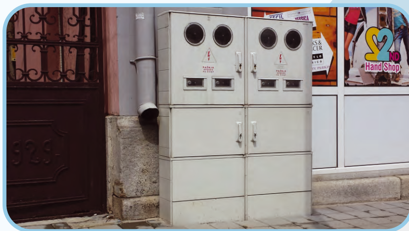
Slobonostojeći uzemni merni orman u Arandjelovcu
