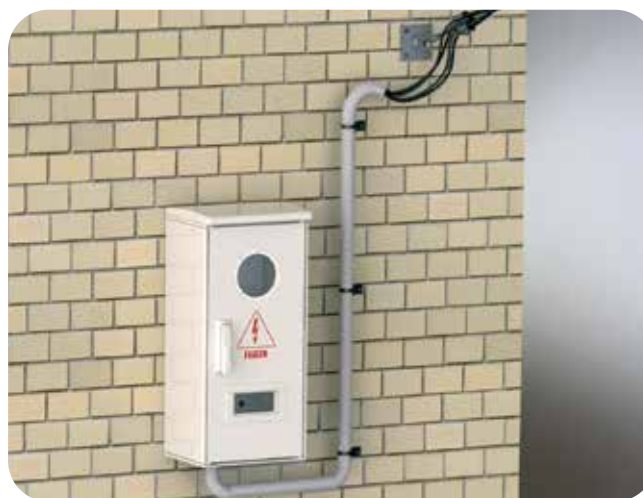
Povezivanje zidnog ormara MRO1
