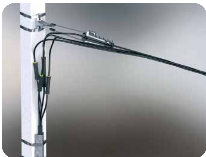
Prelazak kablovskog voda na nadzemni vod
